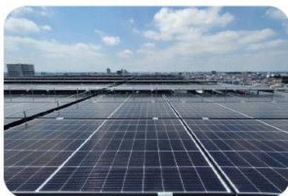
【屋上 太陽光発電設備】
